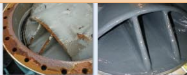
Den korroderade fjärilsventilen – före och efter reparation
