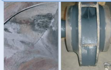
Impellrar och hus innan reparation. Allvarlig nötning och kavitation på impellrarna
